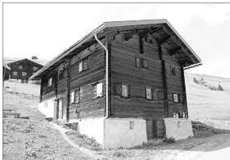
Von der Sonne geschwärzt: Das «Nüw Hus» hat seit seiner Erbauung 1787 zahlreiche Sommer gesehen.
